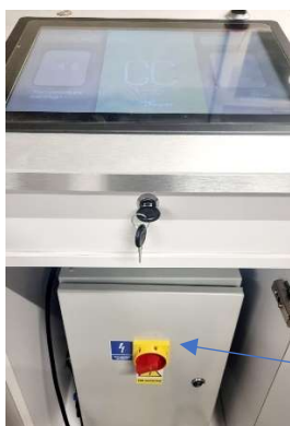
Włącznik Główny urządzenia (w szafce pod monitorem)
